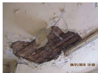
Figura 5.20 Suprafața degradată la planșeul peste parter
