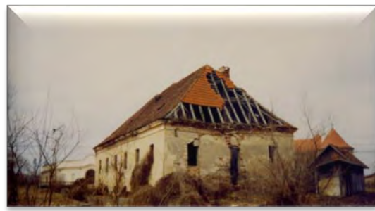
Figura 2.35b Moara în stare avansată de degradare [53]
