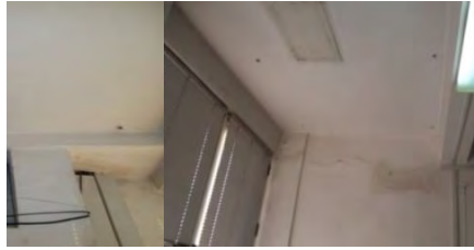
Figura 5.33 Pete uscate din infiltrațiile de apă
