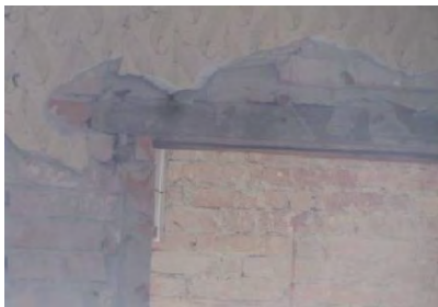
Figura 5.6 Deteriorări în dreptul golului de ușă
