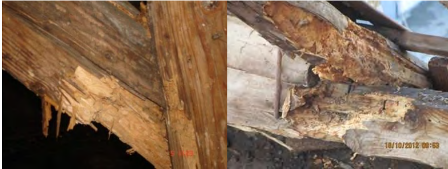
Figura 5.10 Element al șarpantei deteriorat
