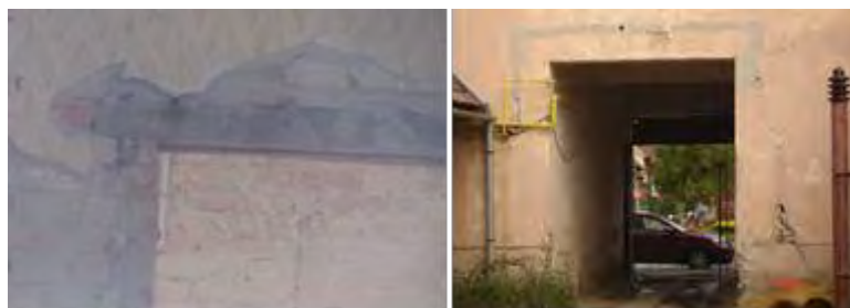
Figura 5.15 Deteriorări în dreptul golului de ușă. Pereți la parter cu fisuri și crăpături
