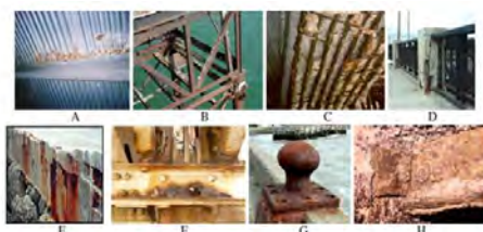
Figura 3.40c Degradarea oțelului în construcții [13]
