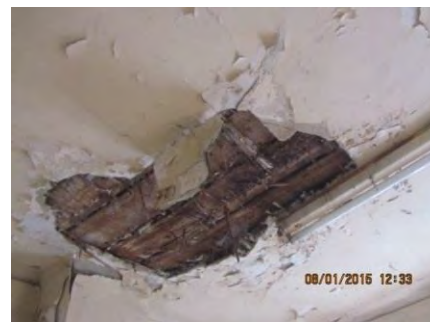
Figura 5.9 Suprafața degradată la planșeul peste parter
