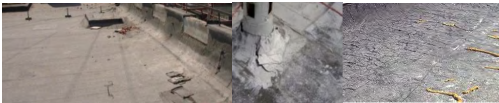
Figura 5.34 Îmbătrânirea materialului bituminos
