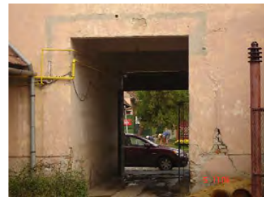
Figura 5.7 Pereți la parter cu fisuri și crăpături
