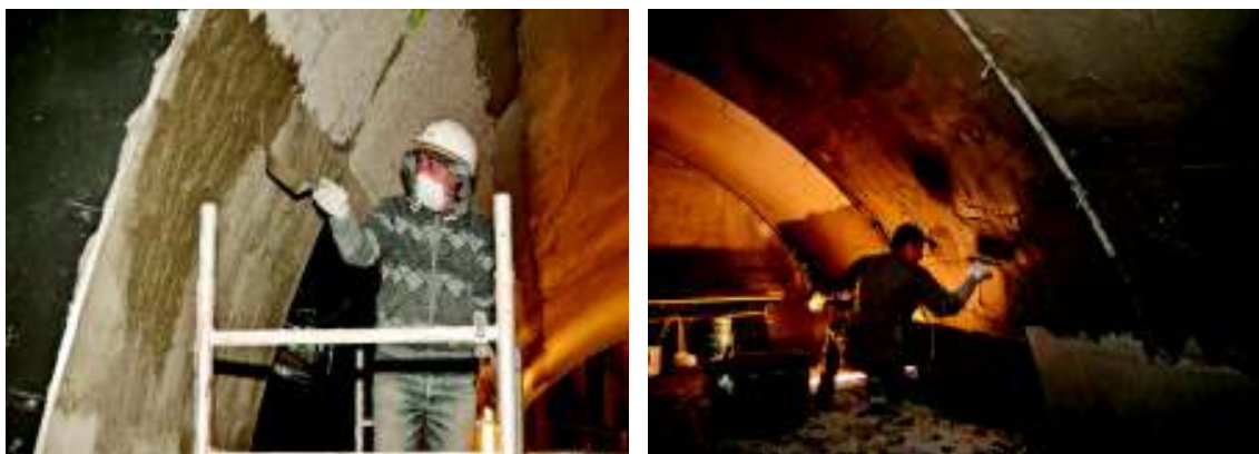
Figura 2.44 – Aplicarea mortarului armat cu fibre Mapei pe structuri subterane din beton, metroul M4, Budapesta [200].
