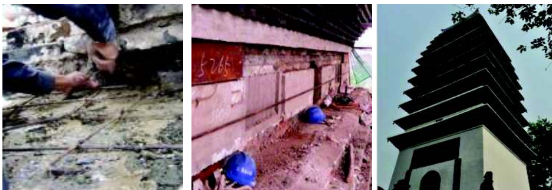
Figura 2.38 – Pagoda Longhu, China – starea degradată în cutremurul din Wenchuan în 2008 și reparată.
