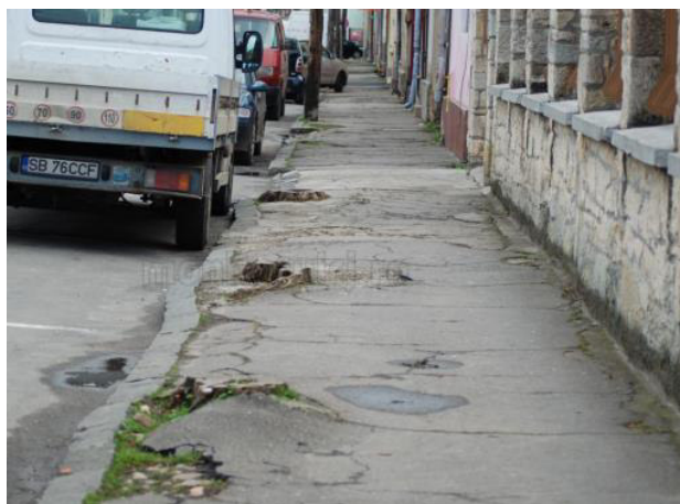
Figura 4.5. Trotuare cu suprafețe degradate
