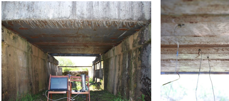
Fig. 5.4.2.-2. Echipament măsurare și amplasare accelerometre
