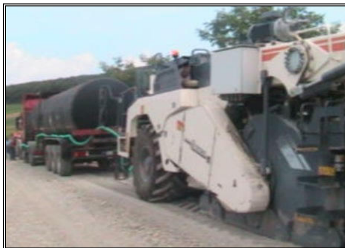
Fig. 6.2. Tren reciclator utilizat în tehnologia de reciclare cu bitum spumat și fibre de sticlă pe DJ 109, limita jud. Cluj – Dragu format din Autogreder, Compactator 12 to, Reciclator WR 2200, Dozator ciment WM1000, Cisternă de bitum cald
