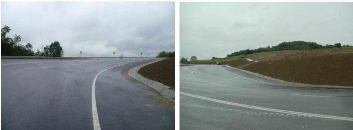
Figura 6.8 Frângerea traseului pe banda 1 de circulație pe DN1C, Km 108+240
