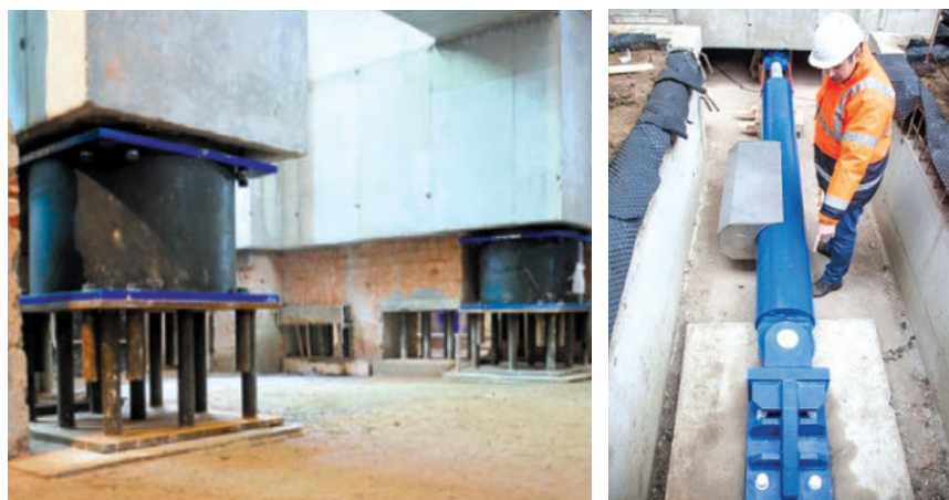
Fig. 2.6 Izolatori și amortizori seismici montați în fundația clădirii Primăriei București [154]
