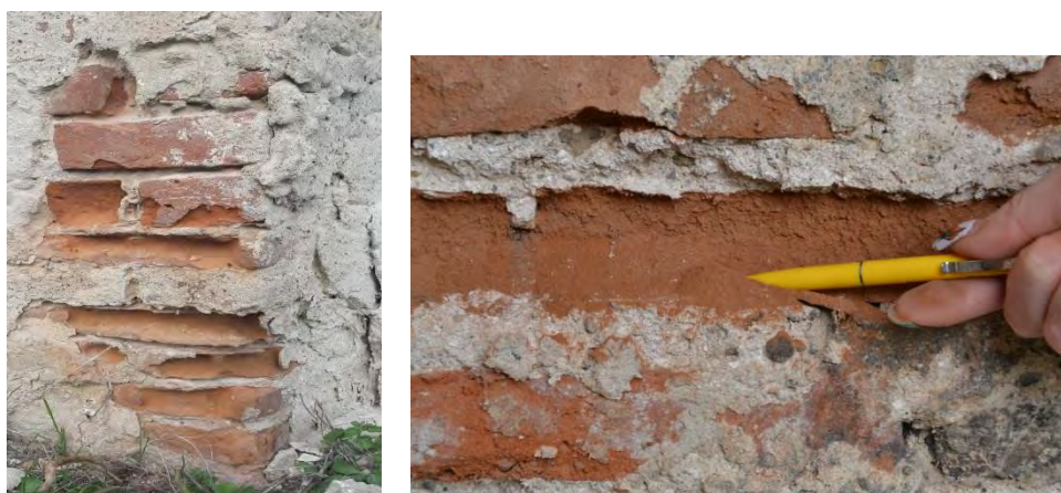
Fig 4.11. Efectul de măcinare al cărămizilor din zidării
