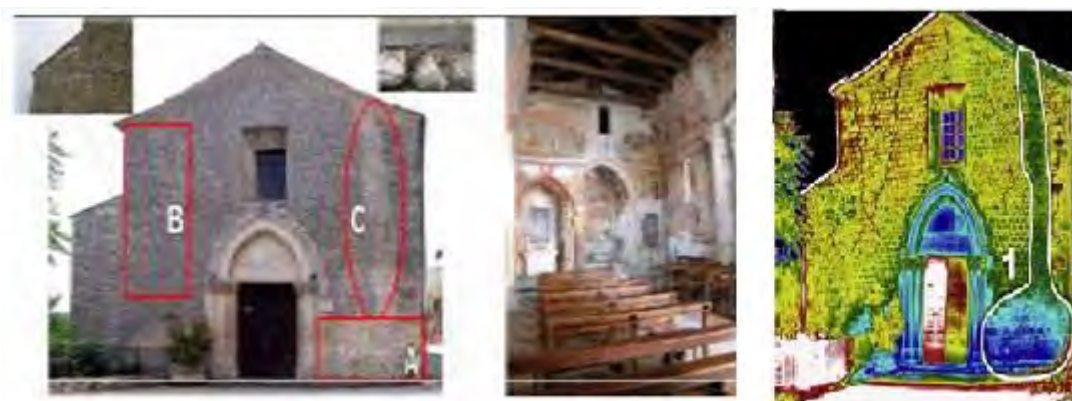
Fig. 2.16 Aplicații ale termografierii în determinarea zonelor umede din anvelopa clădirilor [34]
