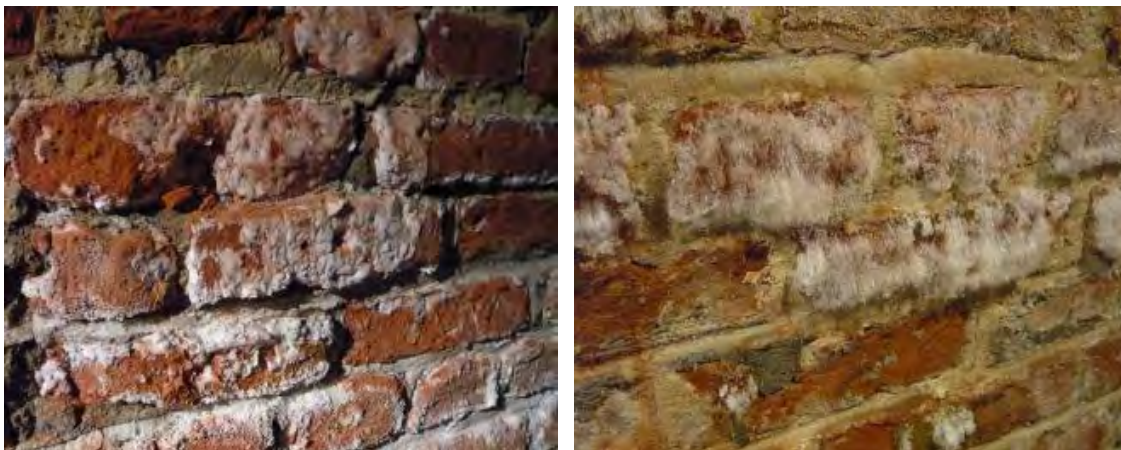
Fig 4.14. Exemple de sulfat de sodiu cristalizat pe zidărie
