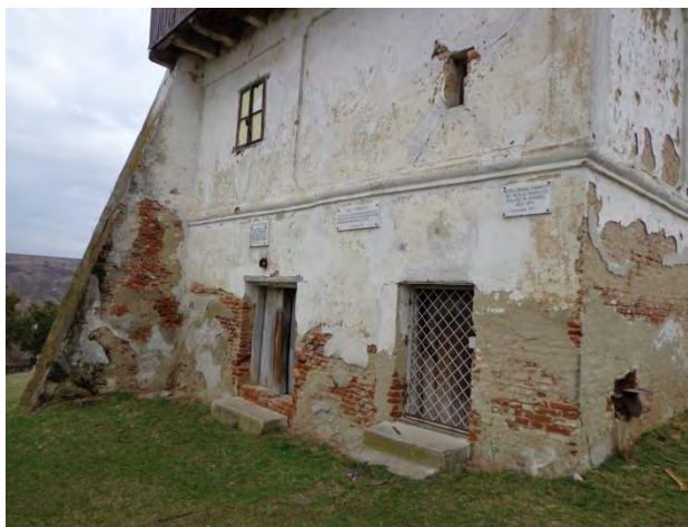
Fig 4.13. Exemple de zidărie afectată de umiditate, Cula Cernătescu
