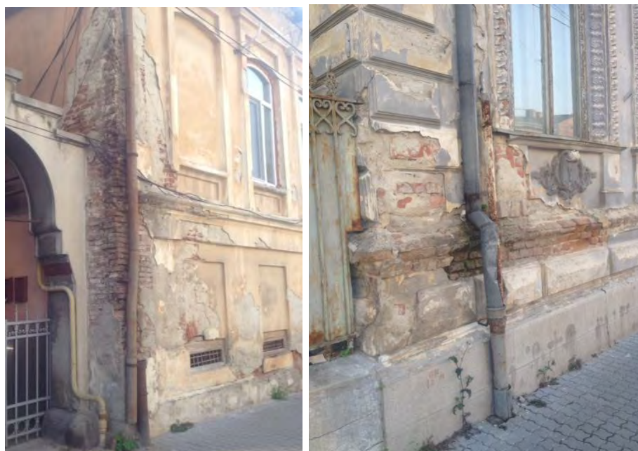
Fig 2.3. Degradări ale tencuielilor și finisajelor exterioare la o clădire monument istoric (Casa Teodor, mij. sec.XIX, nr.347) din Craiova, zona centrală
