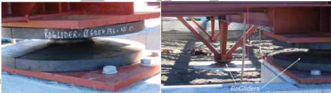
Fig. 2.35 Izolator RoGlider™ instalat la spitalul din WANGANUI [110, 136]
