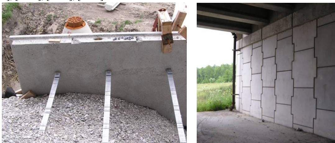
Fig.5.67. Aspecte ale punerii în operă a sistemelor de sprijin de pământ armat din elemente prefabricate, [A.206].
