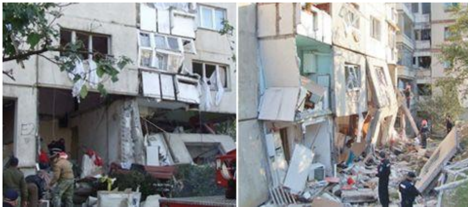
Figura 1.7 Explozie bloc de locuințe (Zalău, 2007) [13]
