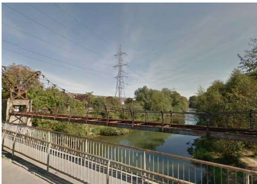
Figura 6.1 Pod suspendat cu cabluri afectate de coroziune
