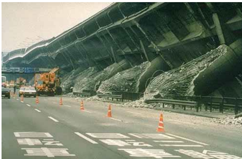
Fig. 2-8. Colapsul autostrăzii Hanshin, Kobe, Japonia 17 ianuarie 1995
