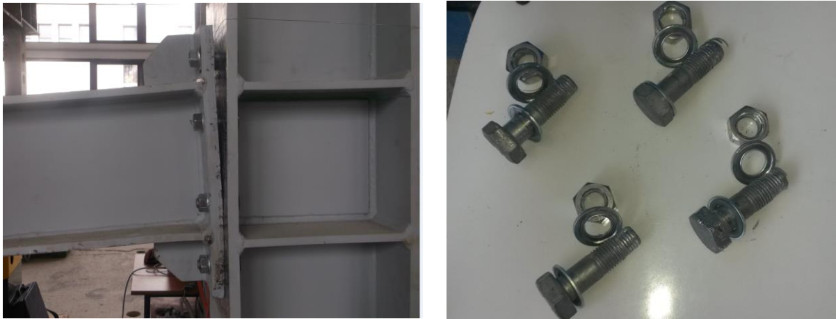
Figura 3-13 Cedarea îmbinării prin deformarea plăcii de capăt și degradarea primelor două rânduri de șuruburi
