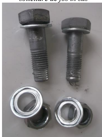
Deformațiile plastice ale șuruburilor
