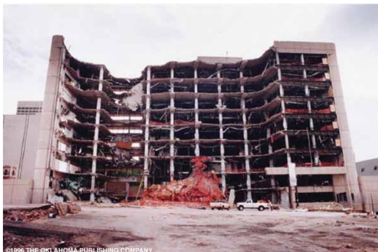
Fig. 1.3. Clădirea Federală Alfred P. Murrah, Oklahoma, S.U.A. [9]
