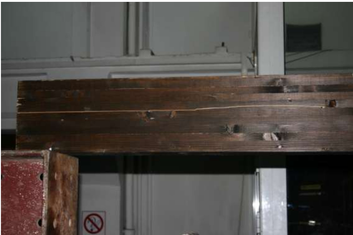
Fig. 4.78- Cedarea prematură a probei R-FIBP-2 datorită unei erori de execuție
