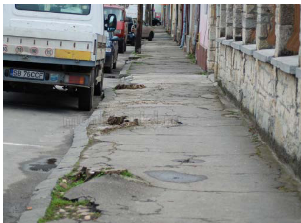
Figura 4.5. Trotuare cu suprafețe degradate
